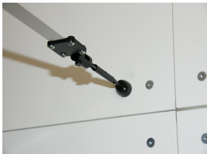
Tirante installato a parete
